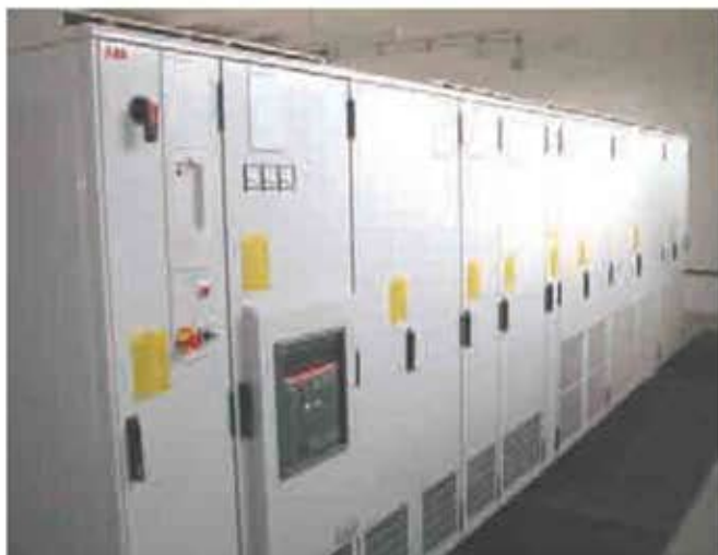
Fig. 1 - Acționare electrică reglabilă AER 1x900kW/6kV.
